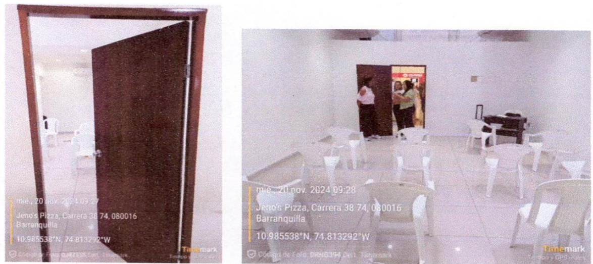
IMAGEN No.3._Tomada del memorando No.20241000159933 de los anexos del acta de visita en donde se evidencia la falta de instalaciones adecuadas y de la oficina administrativa.
