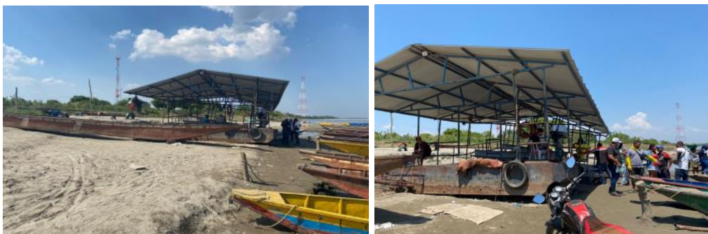
Ilustración 8. Estructura metálica que se utilizaba como muelle.
