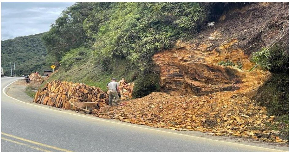
Imagen 1. Extracción de material con posible afectación de la faja de retiro obligatorio y de la seguridad vial en el PR 44+800 de la Ruta 2511.
