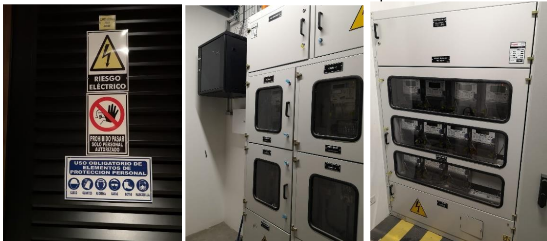
Ilustración 4. Cuarto eléctrico – Sede Principal
